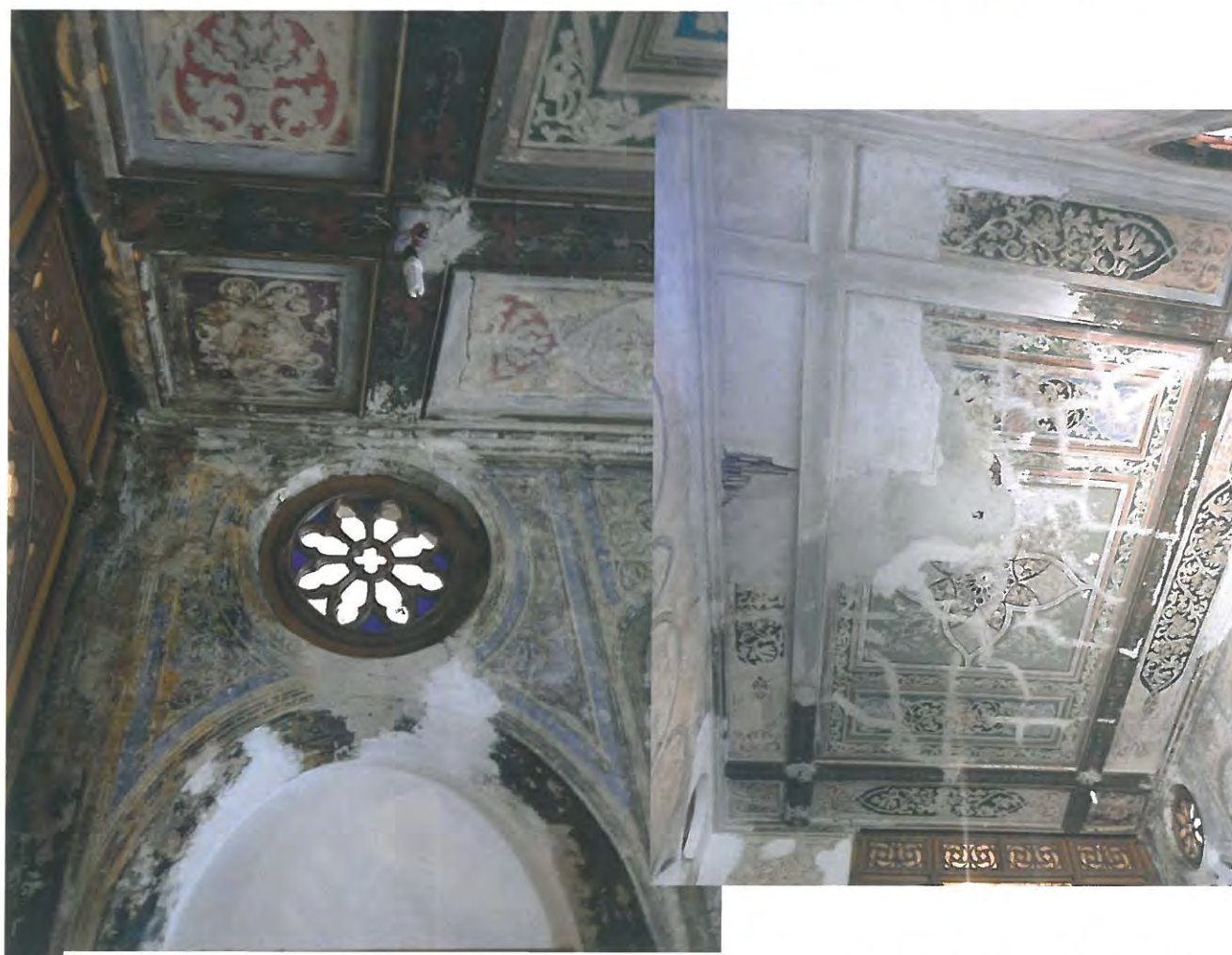
Casa scării principale E01, ansamblu tavan, diverse intervenții din perioada 2003-2005 și ulterior: porțiunile adiacente intrării spre hol, partea superioară cu degradările produse de umiditatea provenită din infiltrații – halouri, decolorări, solziri, pulverulență desprinderi ale stratului de culoare, fisuri ale preparației.
