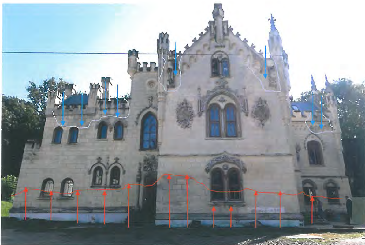
Fațada vestică, umiditatea de capilaritate și porțiuni cu infiltrații la partea superioară.
