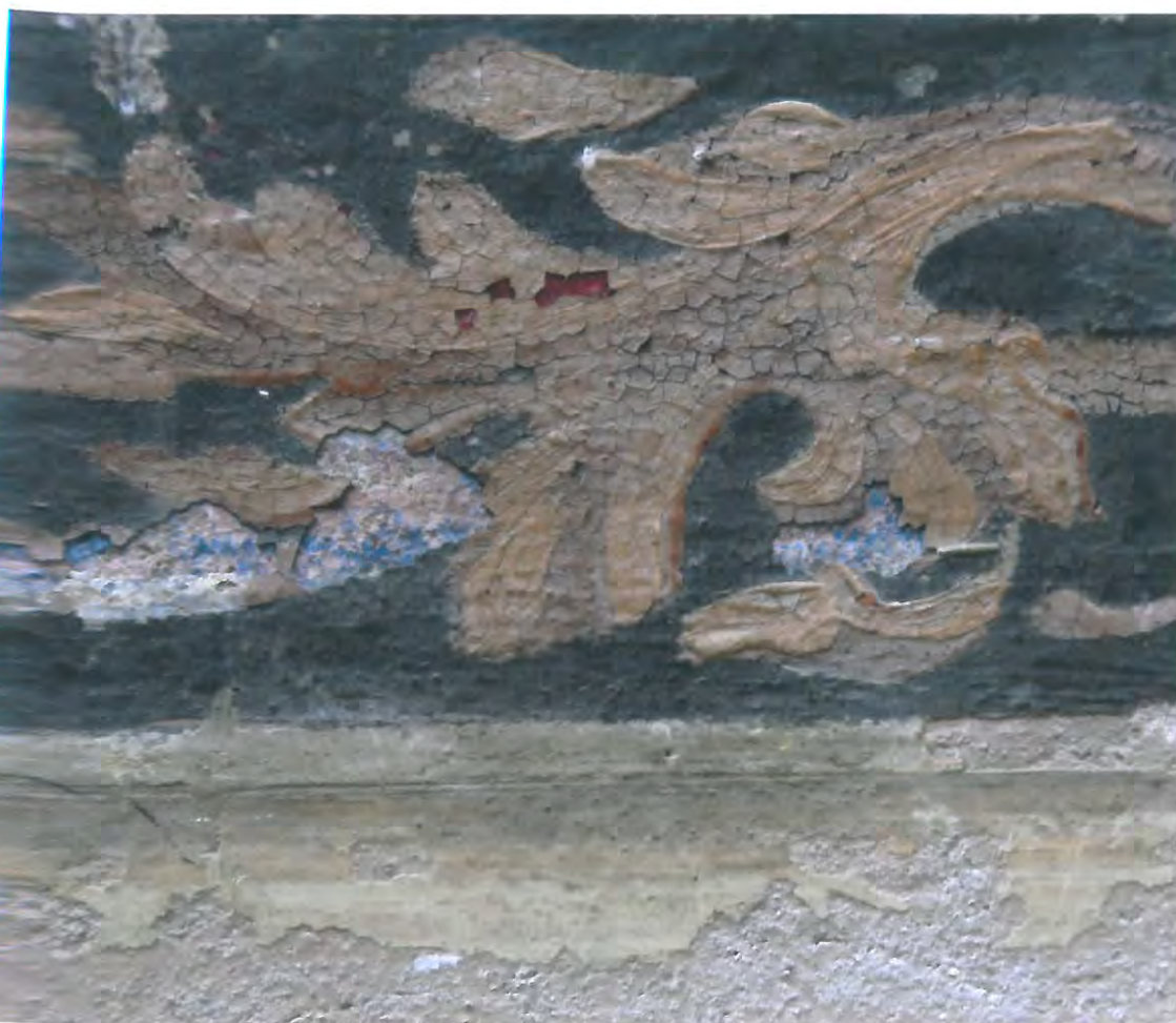
Casa scării principale, perete sudic, aria mediană, detaliu cu element vegetal – solzi, exfoliere, lacune ale stratului de culoare.
