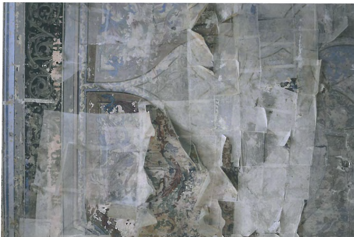
Camera E 03 – living-ul, etaj – tavanul în stare gravă de degradare - atac biologic, strat de culoare pulverulent și strapat pe foița japoneză, exfoliat, lacune – produse de infiltrații repetate și climat fluctuant.
