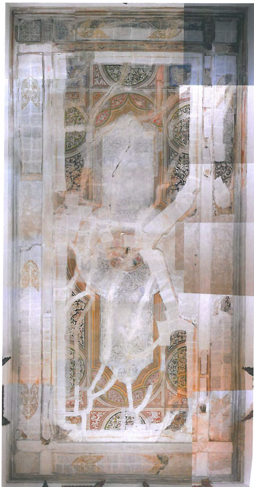
Salonul castelului (încăperea E04), tavanul decorat cu pictură murală – ansamblu cu intervențiile din 2003-2004 pentru asigurarea picturii cu facing și consolidarea structurii și preparăției grav dislocate și desprinse, porțiuni cu infiltrații.
