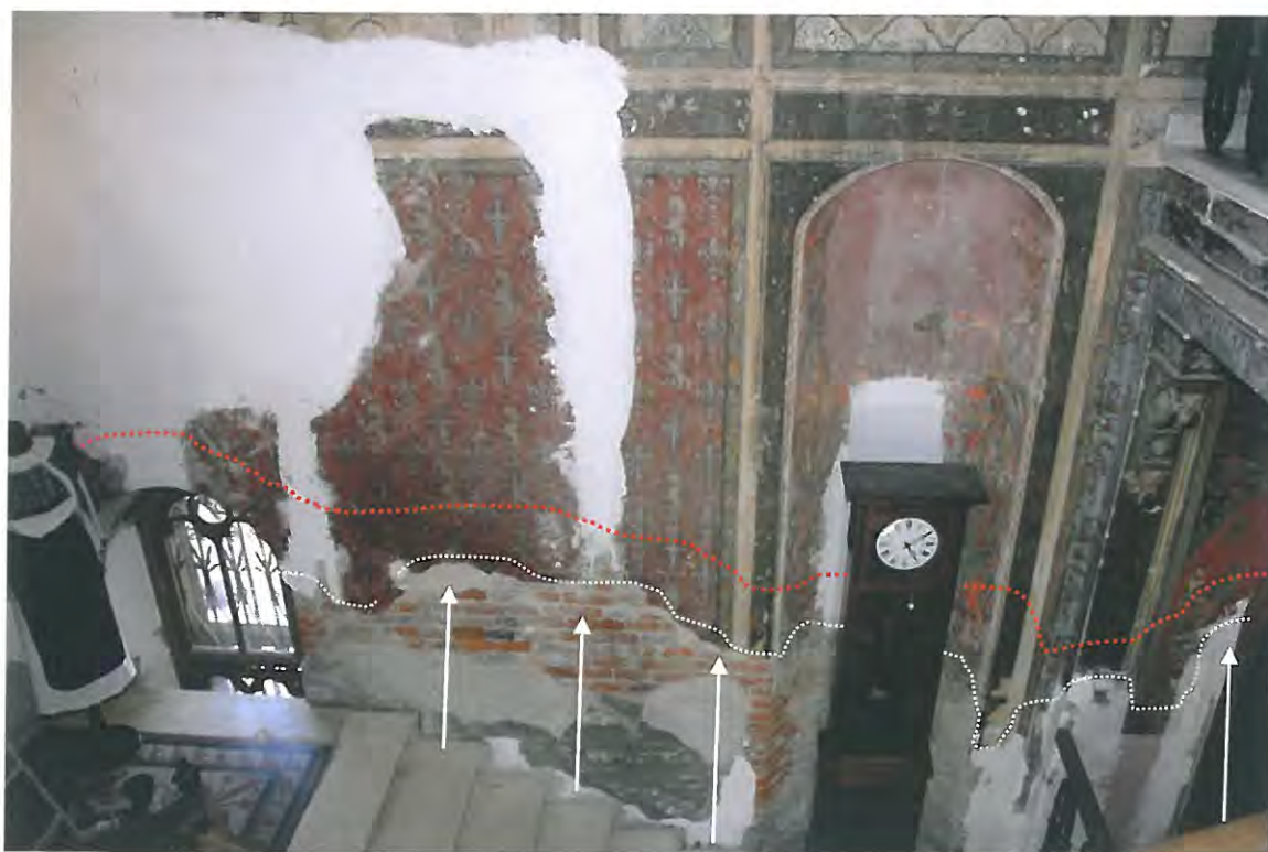
Castelul Sturdza, peretele nordic al casei scării principale de acces către etaj, partea inferioară, ariile afectate de umiditatea capilară și reparații, suprafețele de pictură care prezintă lipsă de aderență sunt deasupra zidăriei vizibile.
