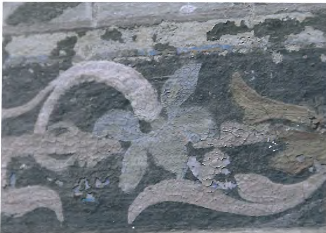
Casa scării principale, perete sudic, aria mediană, detaliu cu element vegetal – solzire, exfoliere, lacune ale stratului de culoare produse de cicluri de creștere / scădere a umidității.
