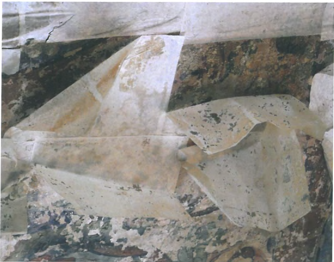
Camera E 03 – living-ul, etaj – tavanul prezintă cele mai grave forme de desprinderi, burdușeli, atac biologic, stropi de ciment, strat de culoare pulverulent și strapat pe foița japoneză, exfoliat, săruri, – produse de infiltrații și climat fluctuant. Detaliu.
