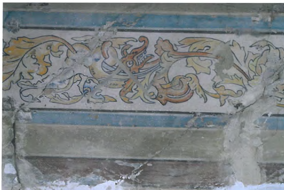
Camera E 12 –partea nordică, etaj – tavanul cu o suprafață mare de reparații care completează partea pierdută, atac biologic, strat de culoare mediu conservat, reparații vechi și noi pe fisuri, lacune produse de infiltrații repetate. Detaliu.
