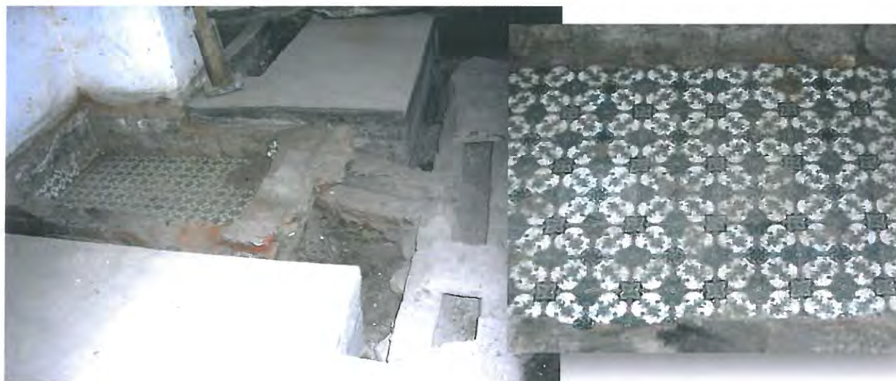
Pavimentul și sistemul de instalației de apă; detaliu. Imagini din 2004, din timpul intervențiilor de urgență.
