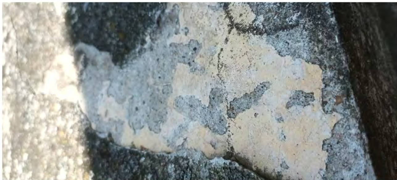
Foto 5 Desprinderi, fisuri pervaz fereastră nord, săruri albe
