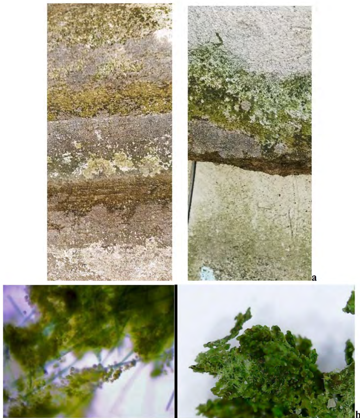
Fig. 3 Alge verzi Chlorococcum sp a. zid fațadă nord brâu decorativ, zid atic sud b. OM x500
