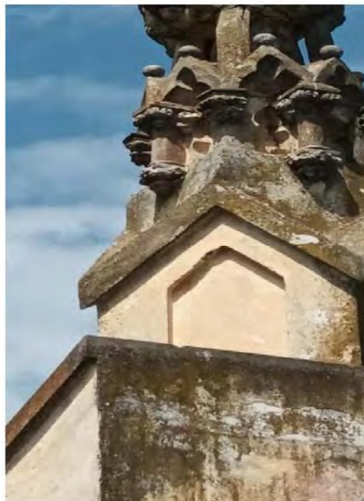
Foto 10 Eflorescențe săruri, umiditate, desprinderi material, biocrustă formată din licheni și alge la nivelul fleșelor
