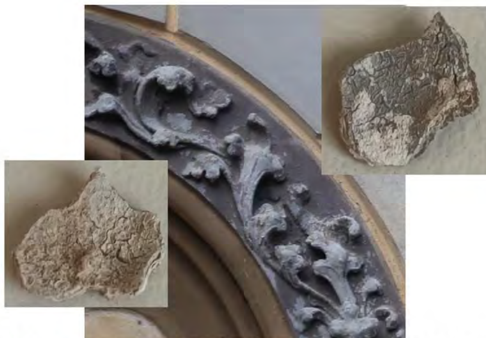
Proba P27a. Façada sud, partea centrală, fronton fereastră, partea superioară, elemente profilate – vegetale, probă din stratul de culoare solzit gri (la suprafață) + strat de preparație subțire.
