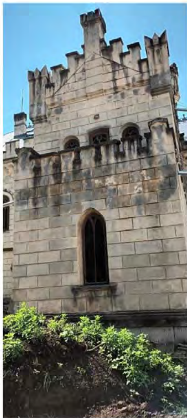
Foto 4 Halouri de umiditate, crustă neagră, desprinderi perete nord
