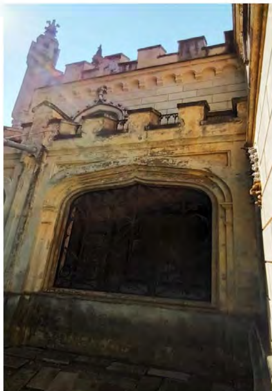
Foto 8. Fisuri, pete umiditate, crustă biologică terasă Vest
