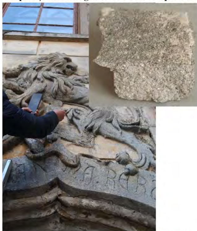
Proba P21. Fațada vestică, intrare secundară, decorație heraldică profilată - Leu cu șarpe localizată deasupra intrării, probă din preparație cu urme de var ocru (lavabil) prelevată dintr-un rost al plăcii suport a decorației.
