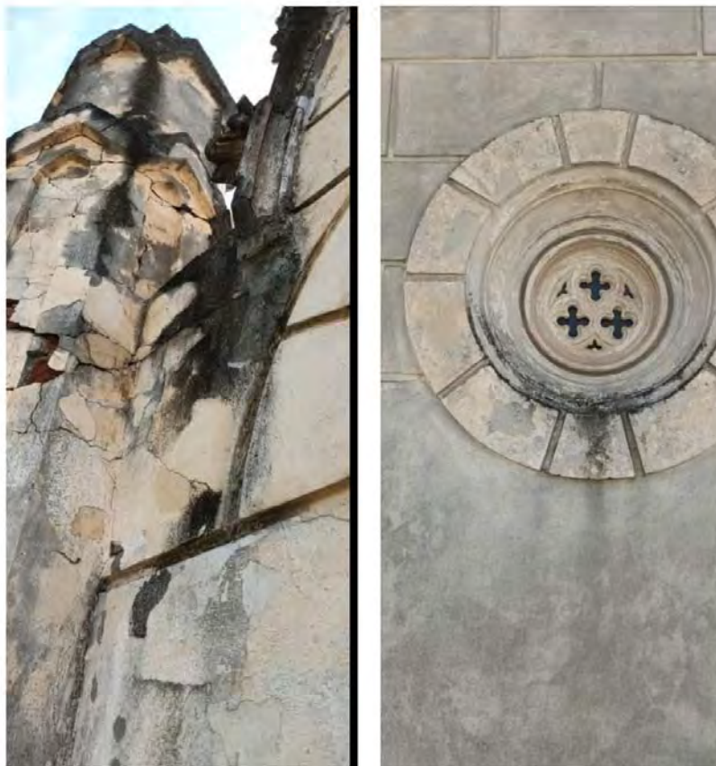
Foto 3 Crustă neagră, desprinderi, fisuri fațadă nord, fațadă sud
