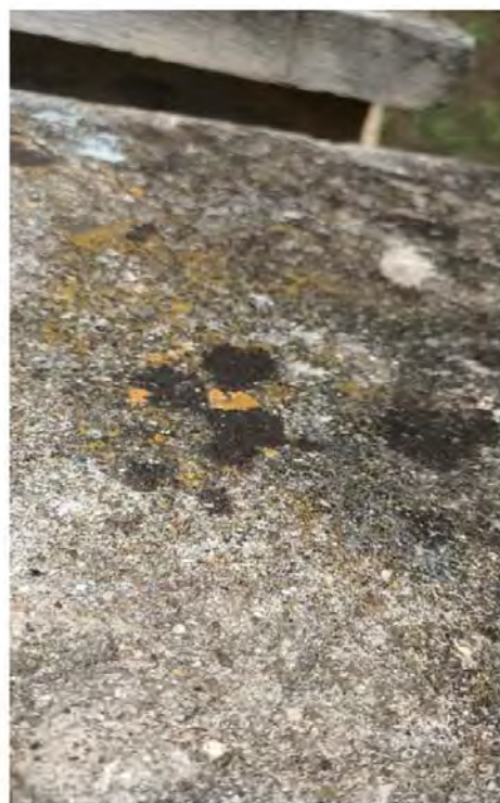
Foto.1. Biocrustă neagră și verde la nivel superior fațadă nord, zona aticuri, fleșe
