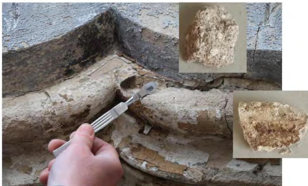
Proba P23. Fațada vestică, intrare secundară, probă prelevată din profilul de tencuială + urme de culoare verde-brun al ancadramentului intrării, de la partea superioară.
